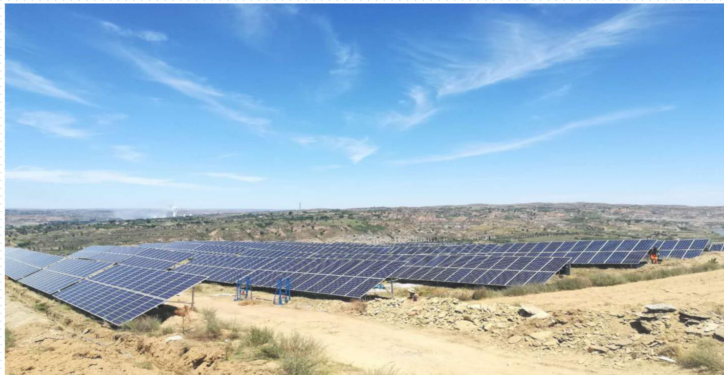
山西河曲村级光伏扶贫项目
