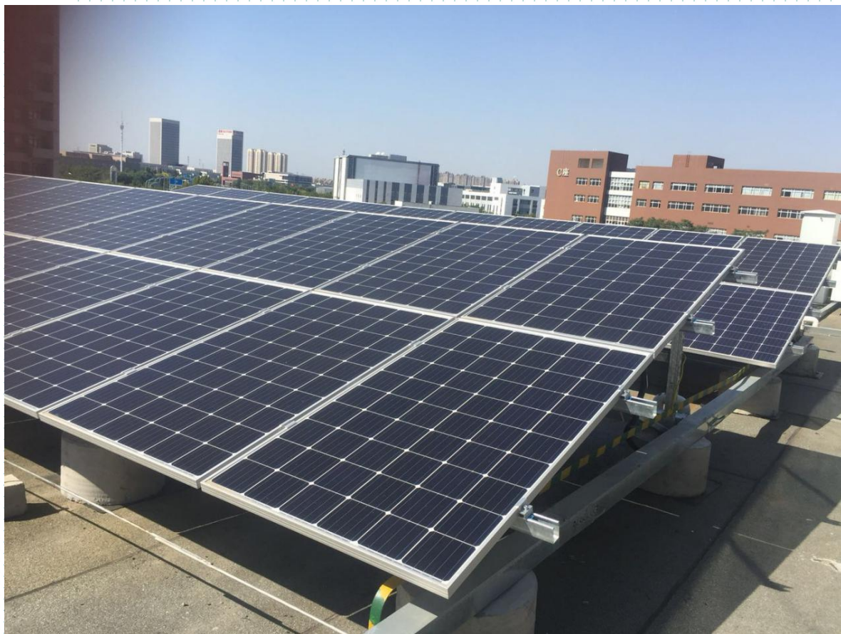
天津药监局光伏屋顶分布式项目
